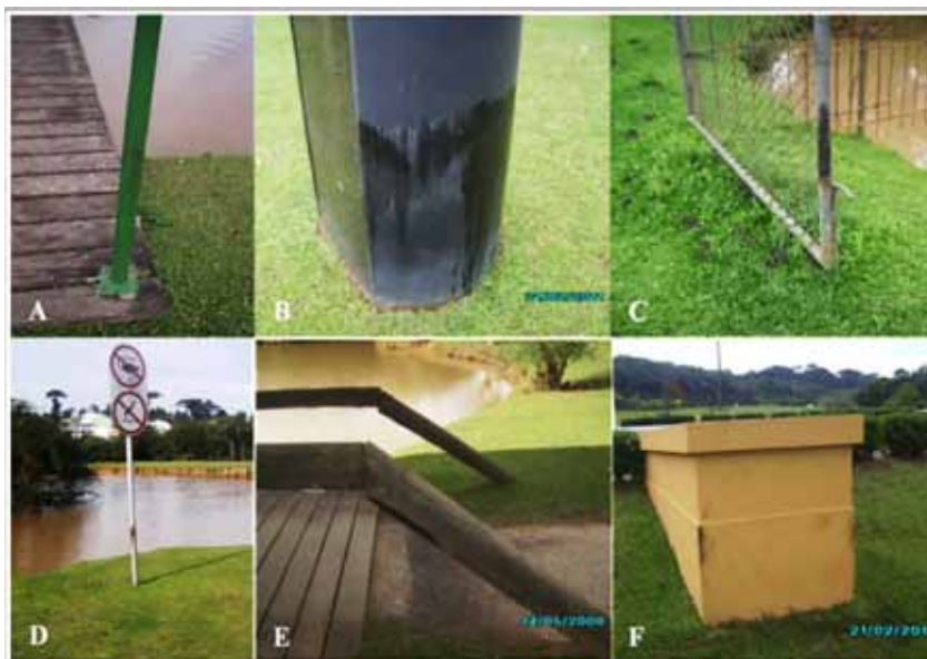
Figura 2. Manchas deixadas por capivaras em estruturas: (A, B, C, D) metálica; (E) de madeira; (F) de cimento.
