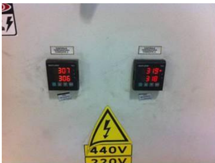
Figura 5. Controladores de temperatura.
