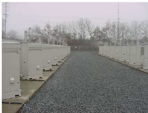
Figura 10. Generación distribuida Long Island, USA Baterías de celdas de combustible
