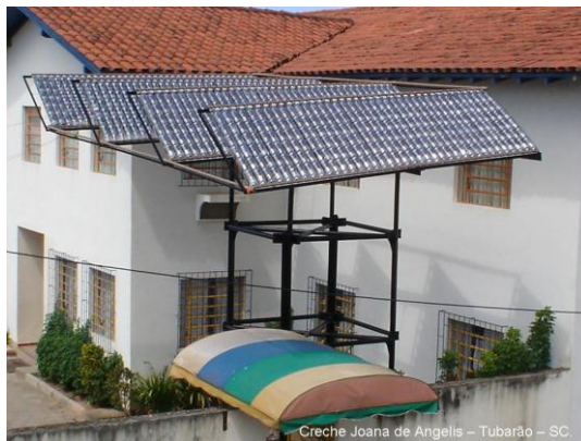
Figura 7. Sistema de aquecimento construído com garrafas PET. Fonte: José Alcino (2004).
